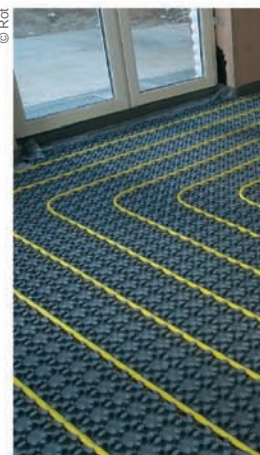
B : plancher chauffant
